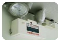
緊急照明設備
